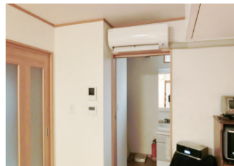
▲1階のエアコンはLDKと脱衣所の間に設置。真冬の脱衣所もポカポカ暖かく、リビングと温度差がありません！
