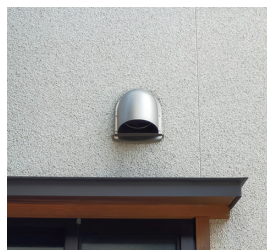
▲24時間換気システムの換気口
