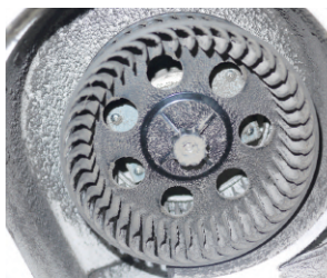
▲10年間掃除していない換気ユニット。ほこりがびっしり…。
